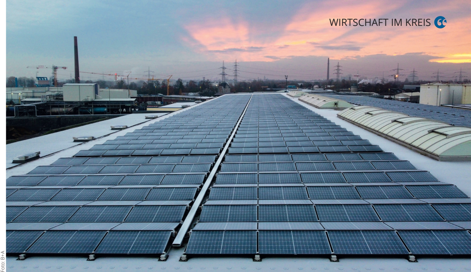
Insgesamt 2.054 Module erzeugen rund 600.000 Kilowattstunden Strom.
