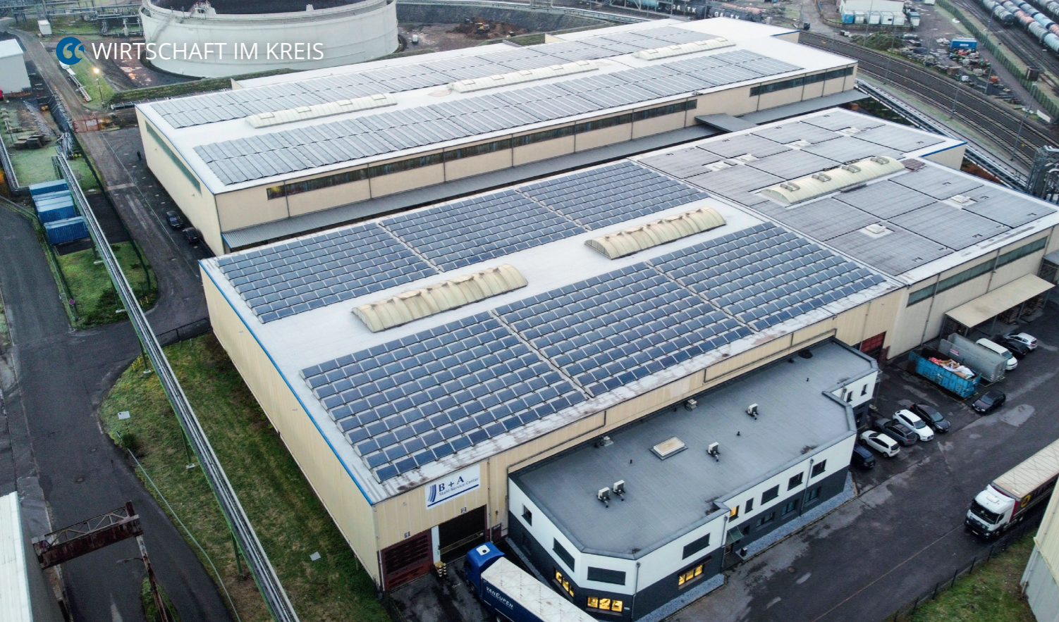
Auf dem Dach der Produktionshalle von B+A hat B&W Energy eine 750 kWp-Photovoltaikanlage installiert.
